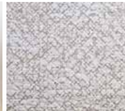
Zersetzung der Nässesperre (durch Hitze und Kontakt mit Chemikalien und Laugen)
